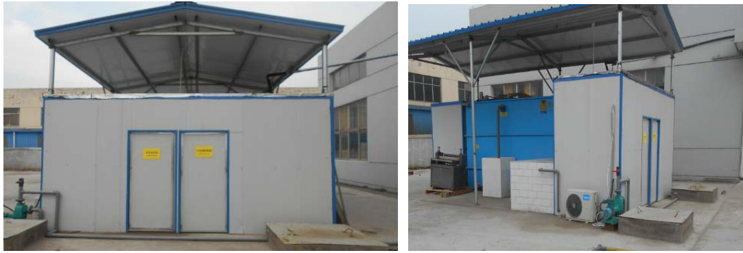
图 4-7 项目污水处理站
