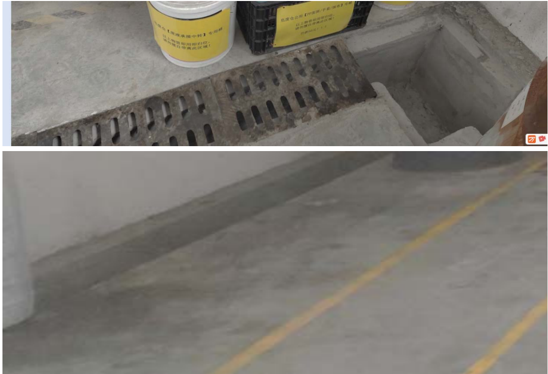
图 4-14 项目危废仓库收集井、导流槽、环氧树脂地面、裙角图
