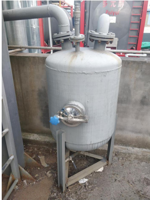
图 4-4 罐区气液分离装置现场图
