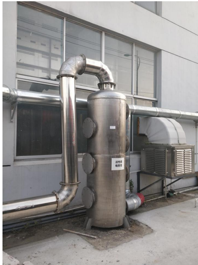
图 4-3 活性炭吸附装置现场图
