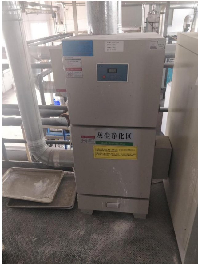
图 4-2 布袋除尘装置现场图
